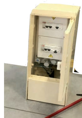
Coffret de rue contenant 2 tableaux
