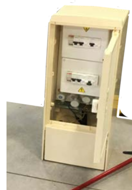
Coffret de rue contenant 2 tableaux
